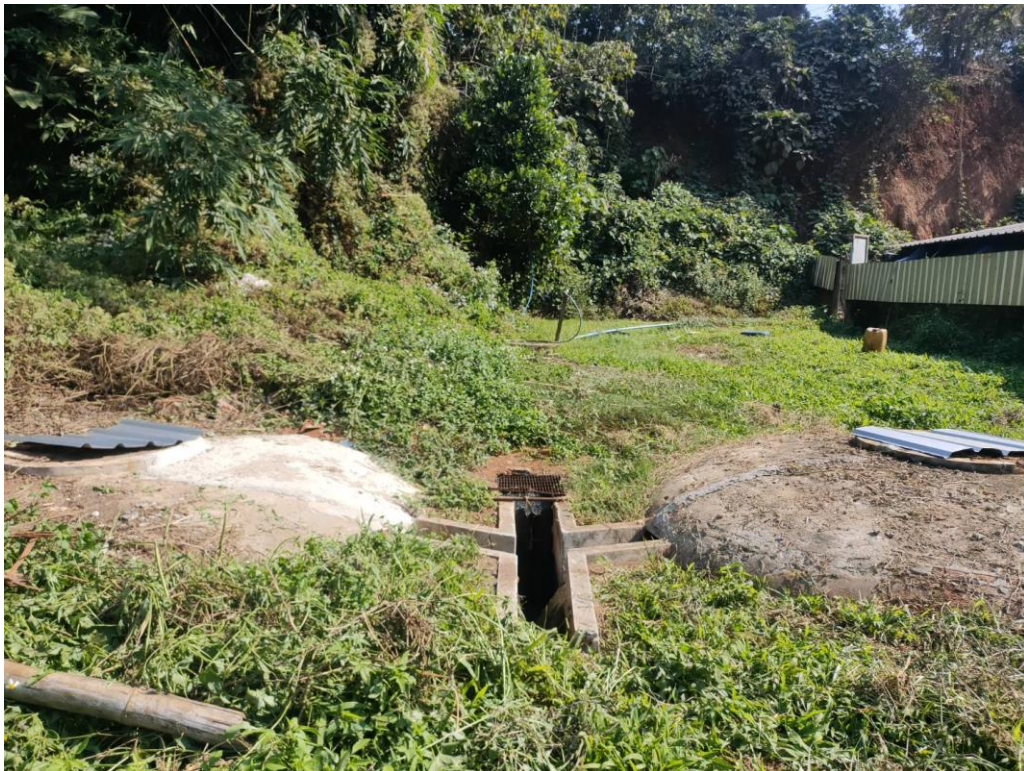
ภาพระบบบำบัดน้ำเสียชนิด CD-Junior
