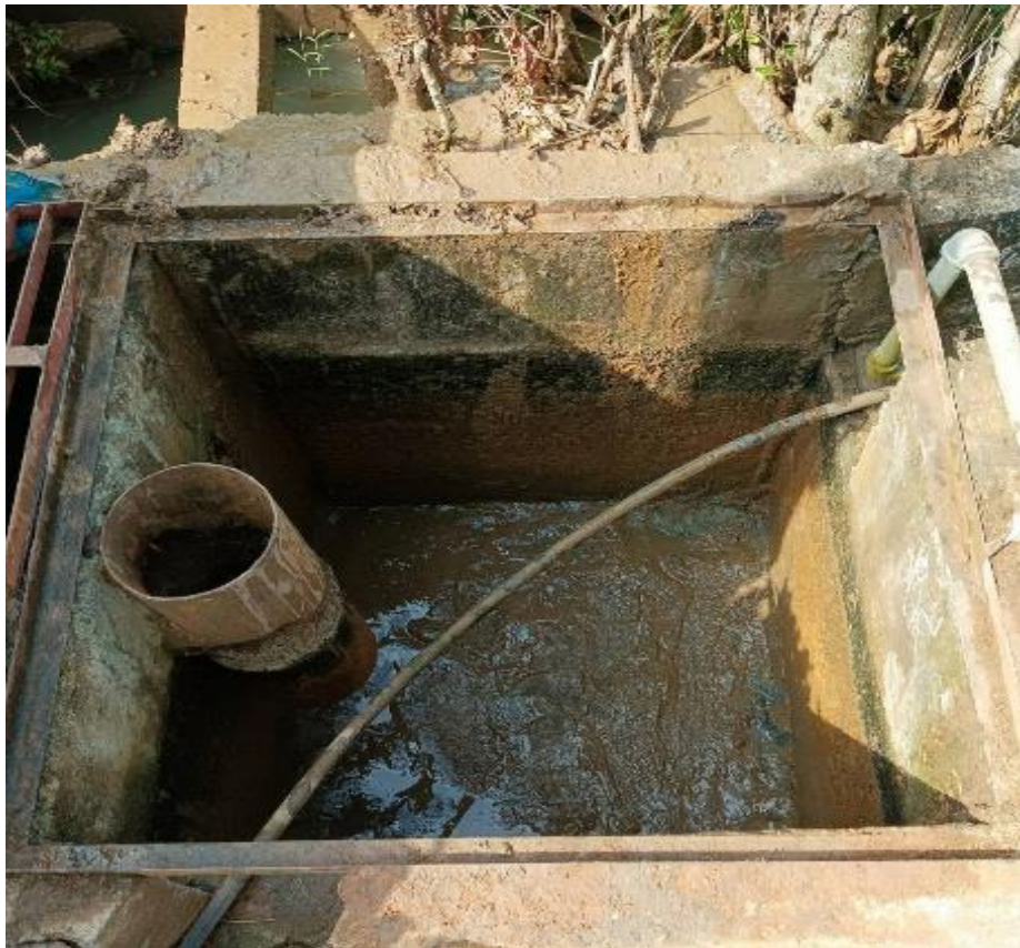
ภาพระบบบำบัดน้ำเสียชนิดบ่อดักไขมัน
