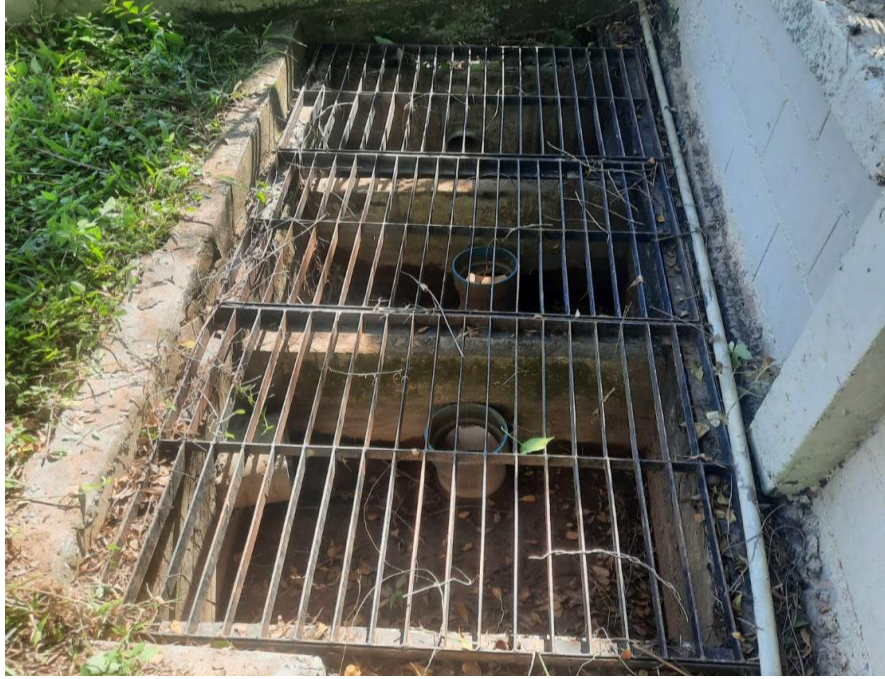
ภาพระบบบำบัดน้ำเสียชนิดบ่อดักไขมัน
